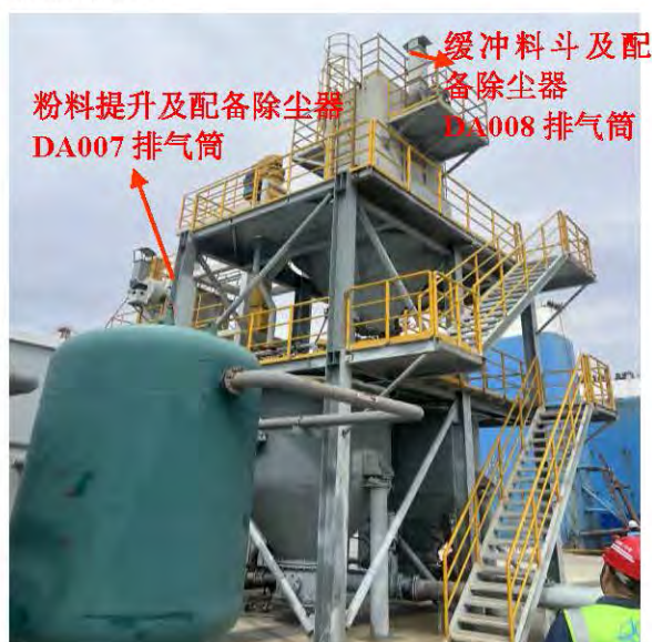
出运码头粉料提升及缓冲料斗及配备除尘器
