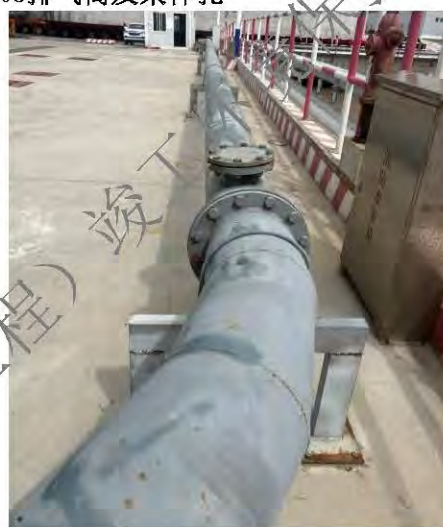
出运码头气力输送管道
