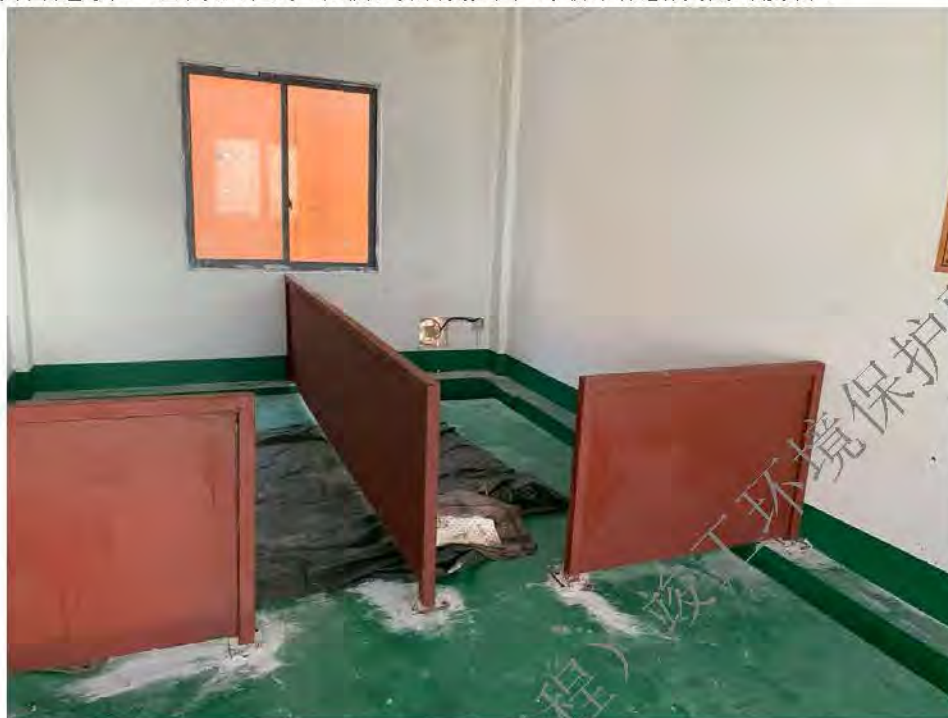
危废暂存间分区、渗滤液导排及收集设施、排风设施、观察窗口
